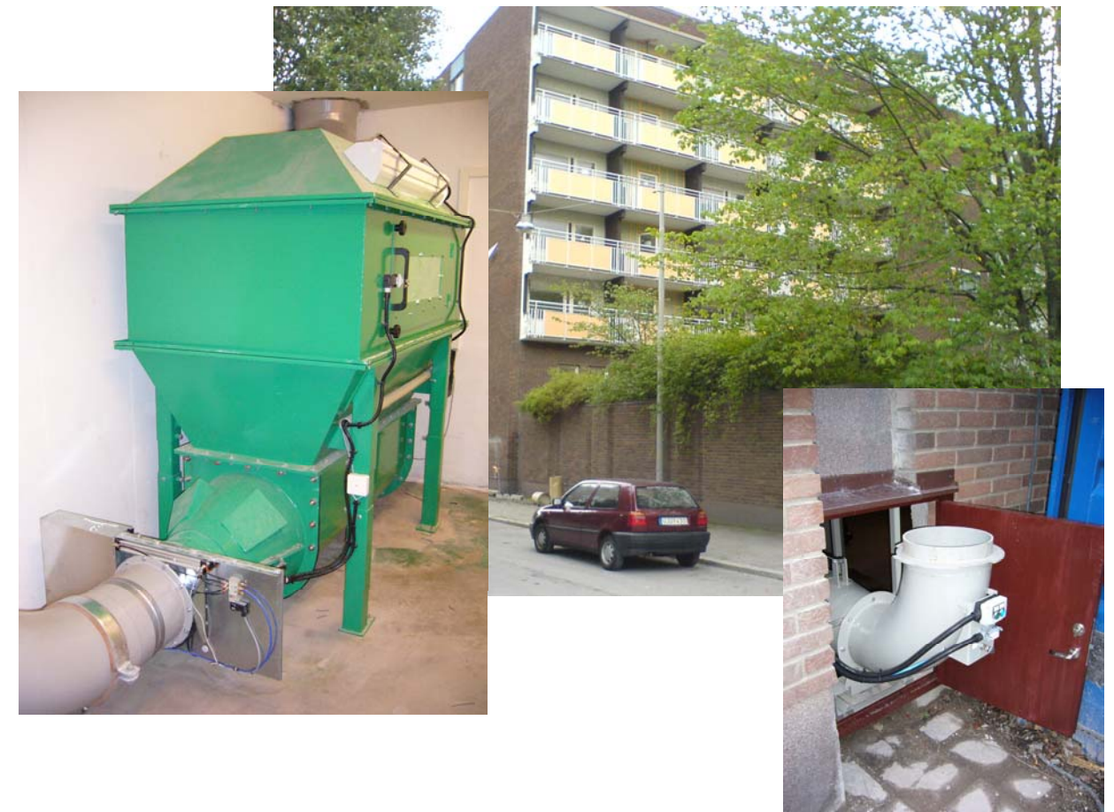
Bilder fra installasjon i aldersboliger, Norrkøping.
